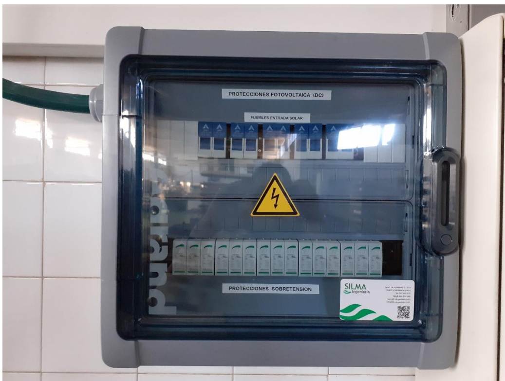
Imagen del cuadro de protección continua
