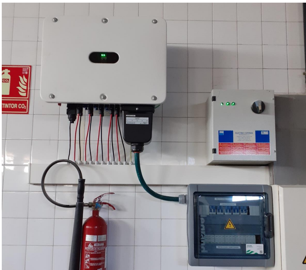
Imagen del inversor y el cuadro de protección continua
